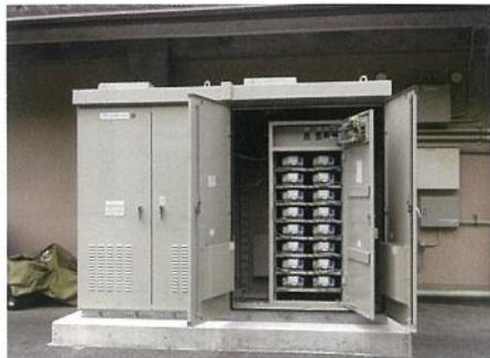
福祉センターのパワコン蓄電池盤
