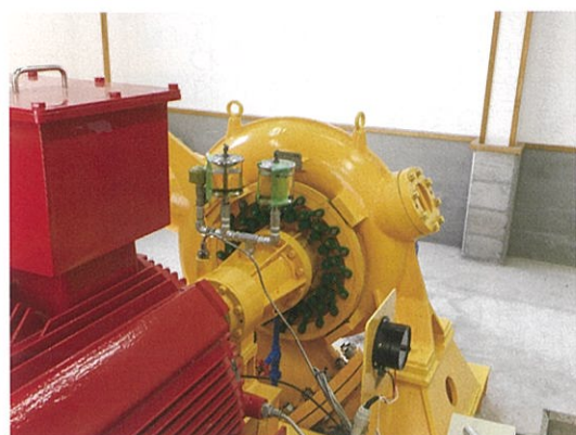
ゆず色に塗装したフランシス水車を導入
