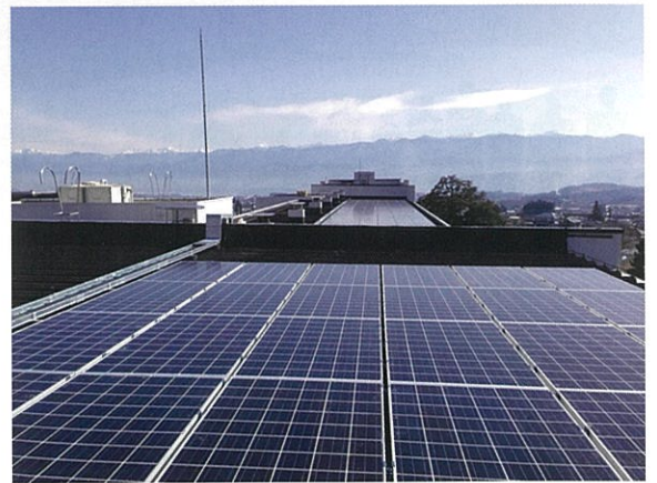
旭ヶ丘中学校屋根に設置された太陽光パネル
