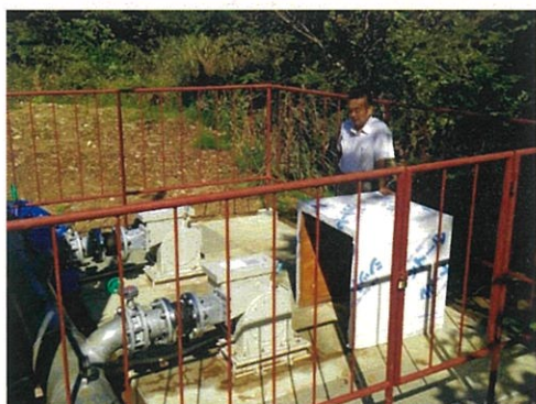
稼働しているクロスフロー式水車2基
